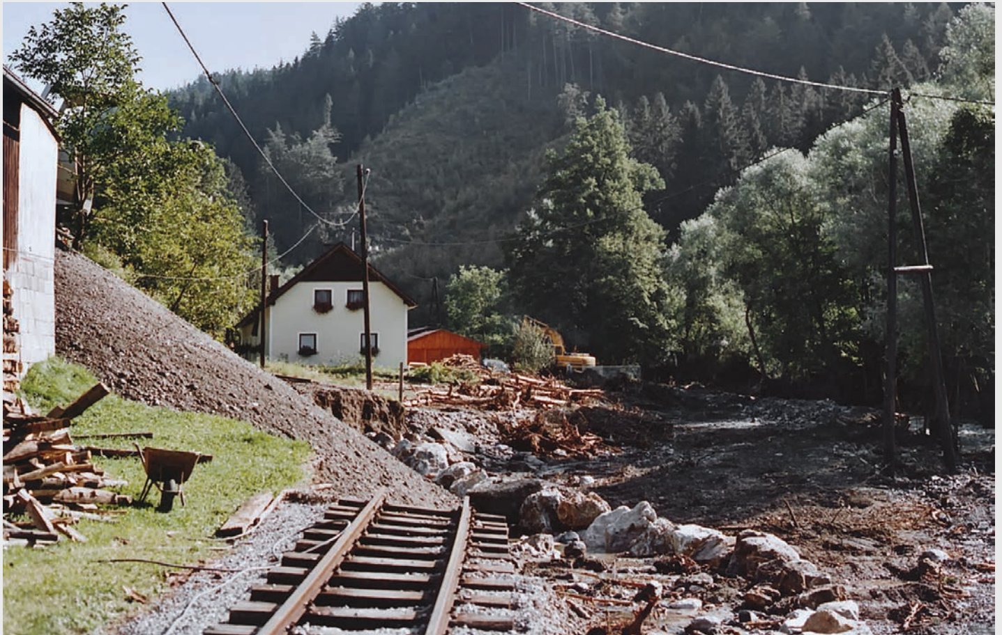
Das Hochwasser des Jahres 2005 spülte auch in Kilometer 2,3 einen Teil der Strecke weg. Im Hintergrund arbeitet ein Bagger bereits an der Beseitigung der schweren Schäden. Bis zur erneuten Befahrbarkeit der Gleisanlagen ist noch viel Arbeit nötig. (Dietmar Zehetner)
