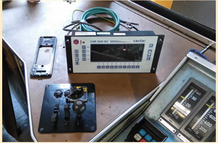
Die neue Zugfunkanlage, die seit ihrem Einbau gute Dienste leistet. (Foto: Robert Köfler)
